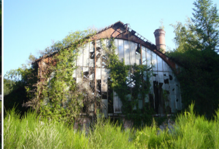
La structure abandonnée de l'ancienne usine Mullard, faite de métal et de brique, disparaît petit à petit sous la végétation.
